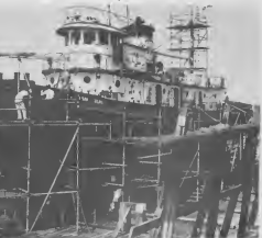
UN BOTO salbahida for di uno di e remolcadornan ta wordé hiza sin angustia esfuerso meico cu un pida lugete door di e grua durante trabao ariba drydock. E portret banda dreci ta muestra trahadornan ta limpi y eccion ariba di e curpa di e remolcadór.
